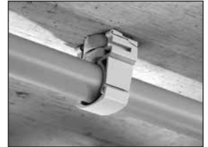
Cable conduits or light duty pipes
